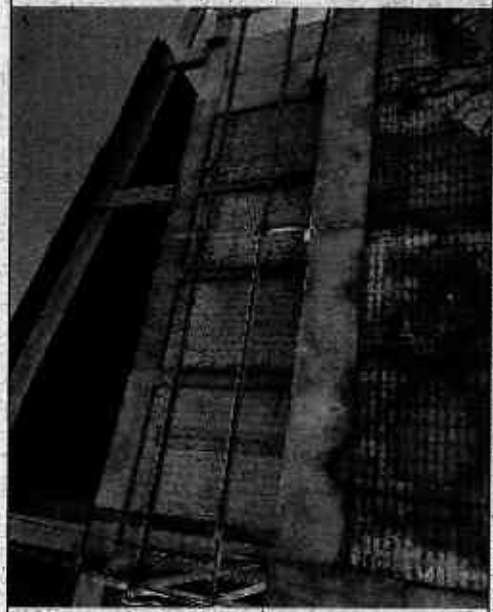
Fotografía N° 6: Ausencia de revestimiento de mortero en muros exteriores del 1er y 2do nivel del área de comedores y administración. Fecha fotografía: 23-02-2018
