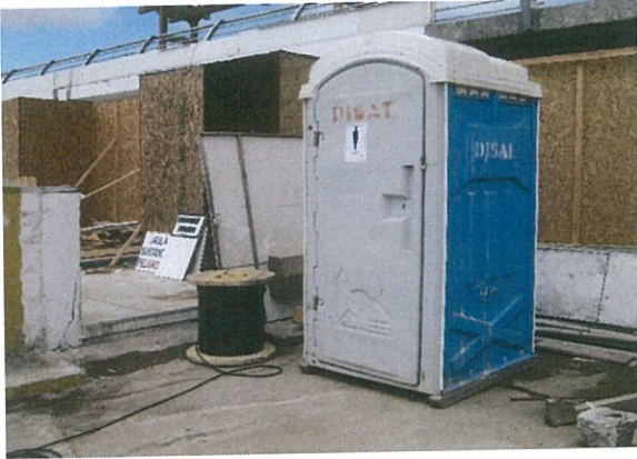
Fotografía N° 1 – 11/01/2016: Vías de circulación y baños bloqueados con escombros y materiales.
