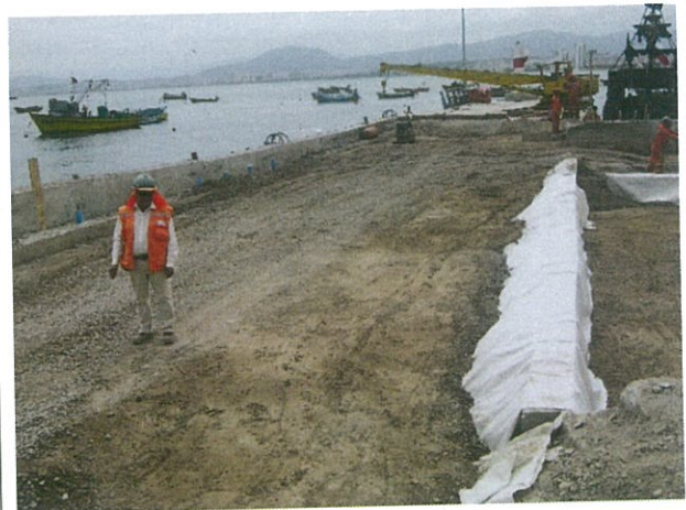
Fotografía N° 4 – 11/01/2016: Sector N° 3, Lanchas, al cual es posible acceder dentro de la obra y que se encuentra con daño estructural.
