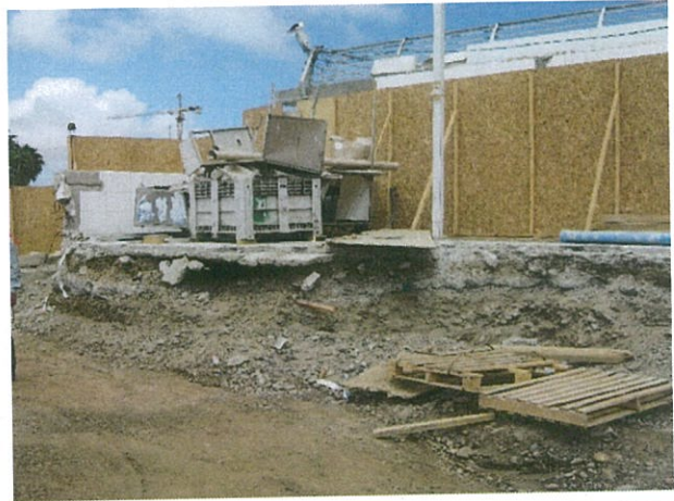
Fotografía N° 2 – 11/01/2016: Escombros y desorden en área de trabajo.
